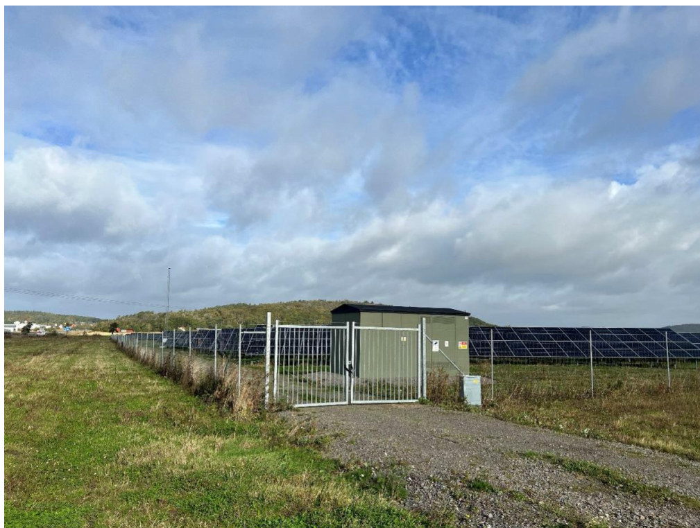
Figur 9. Exempel på staket och grind till solpark Varberg norra, Solkompaniet ©.
