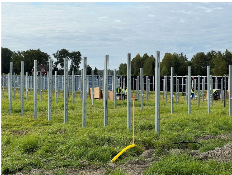
Figur 11. Solpark under uppbyggnad. I bilden syns de pålar som trycks ned i marken.
