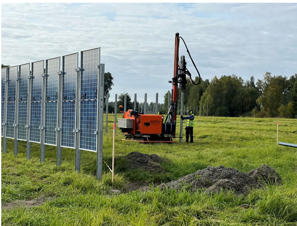
Figur 12. Monterade solpaneler till vänster och i mitten av bilden monteras pålar med pålningsmaskin.
