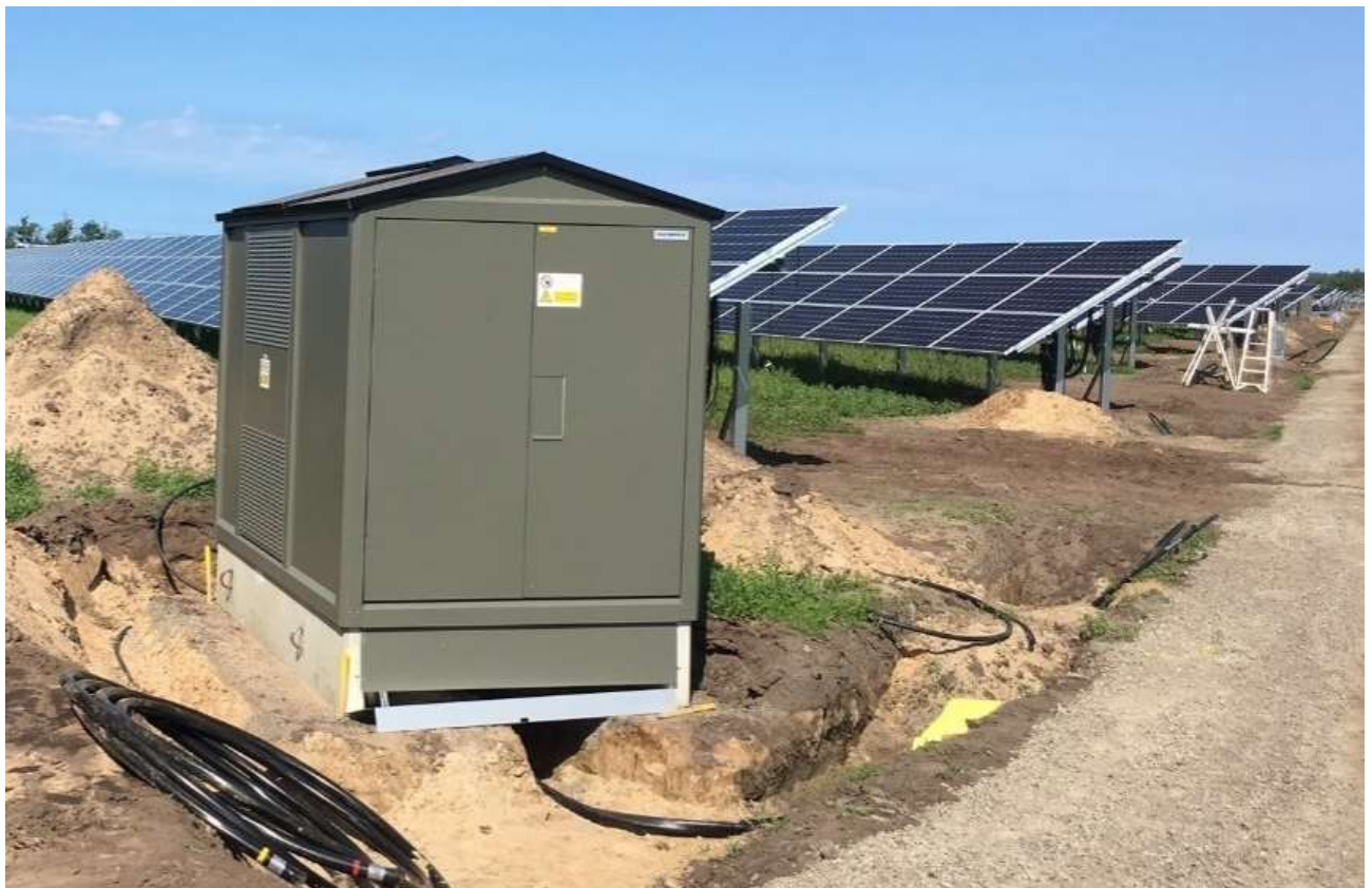
Figur 18. Exempelbild på transformatorskåp.
