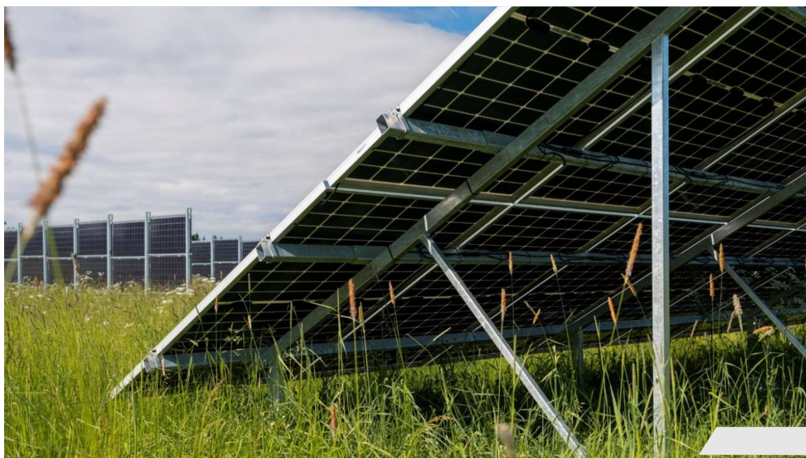
Figur 16. Exempel på stativ med solpaneler.
