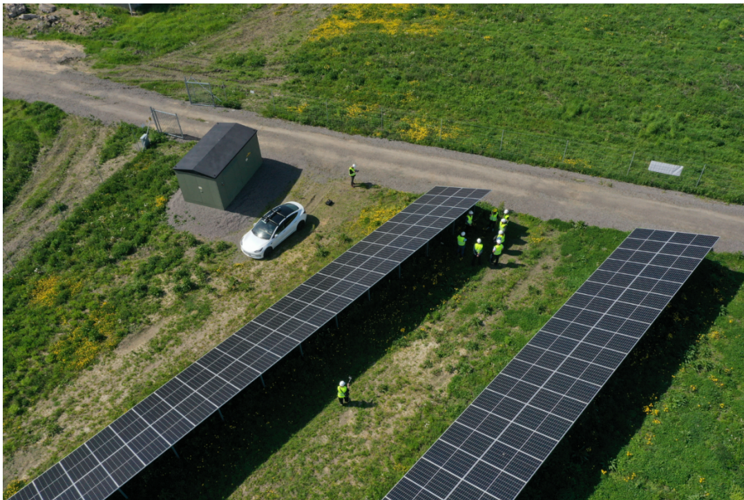
Figur 4. Foto på solpaneler, transformatorstation, nya vägar i parken och stängsel i Solpark Varberg norra.
