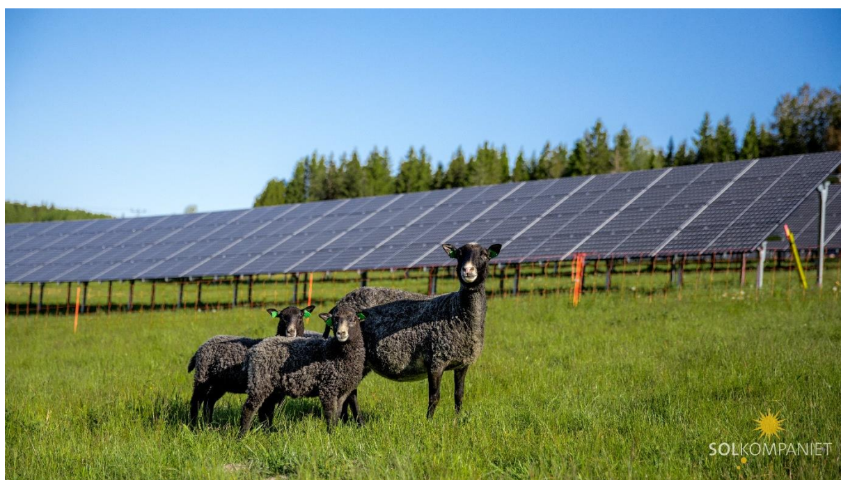
Figur 2. Foto från Linde Energis solpark i Torphyttan som Solkompaniet har byggt.
