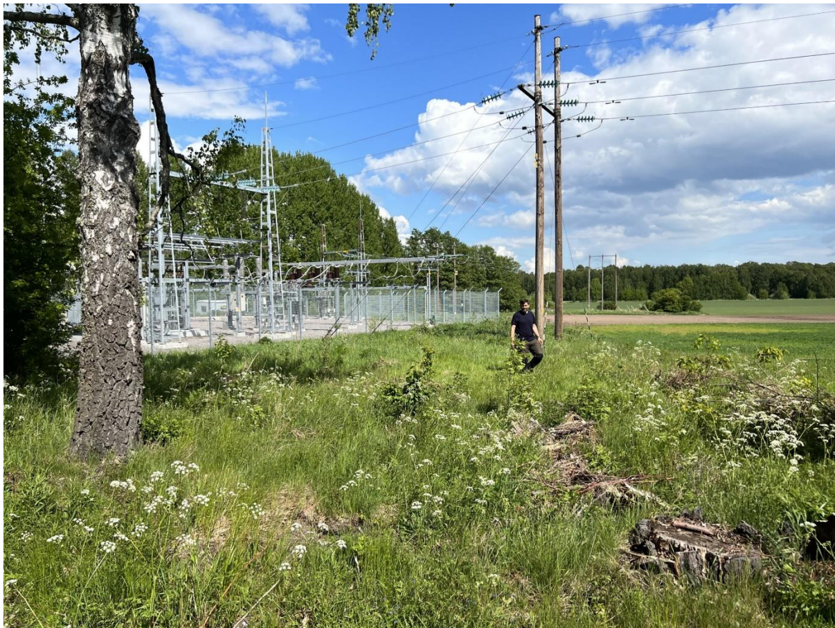
Figur 17. Ställverk vid projektområdets norra spets.
