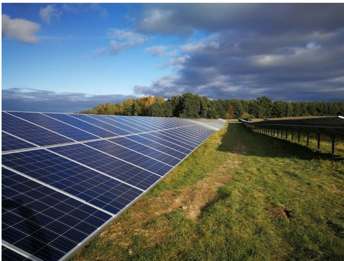
Figur 10. Exempelbild solcellsmoduler monterade på pålar i mark, från solpark i Kalmar.
